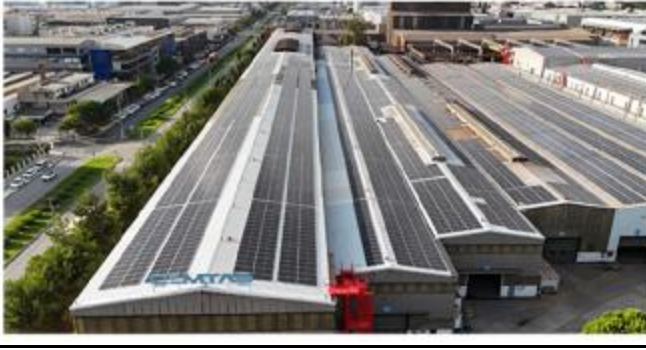
Fabrika Çatı GES
